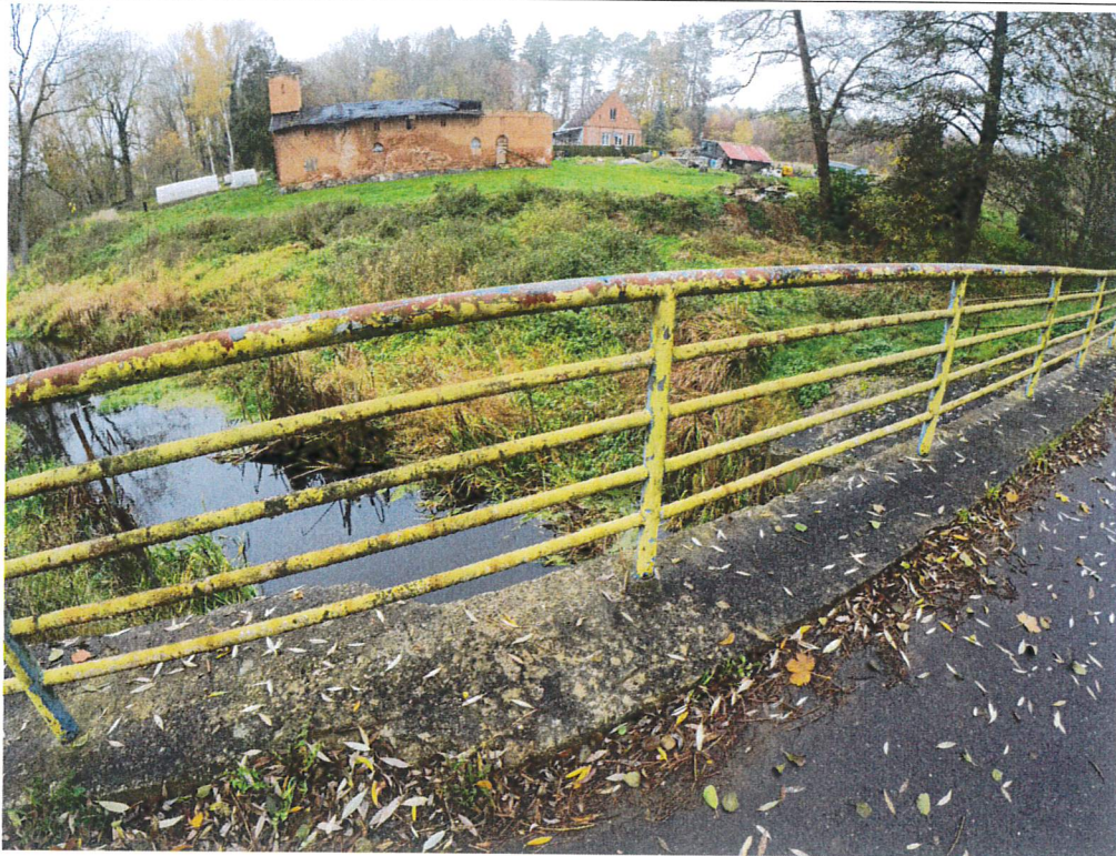
Fot. 1. Złuszczenie warstwy antykorozyjnej balustrady
