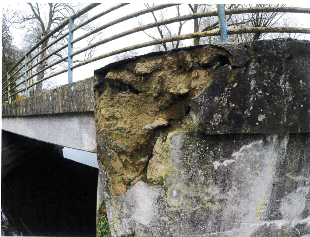
Fot. 4. Ubytki betonu gzymsu i ściany przyczółka
