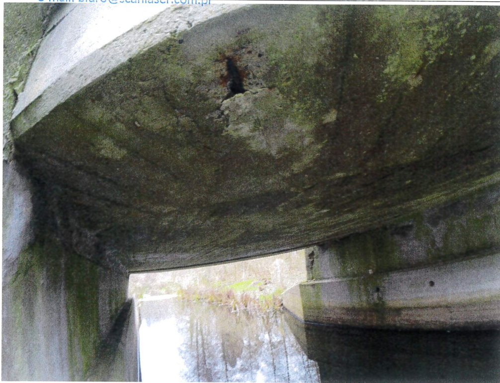
Fot. 3. Zwilgocenie, ubytek betonu, korozja zbrojenia płyty górnej
