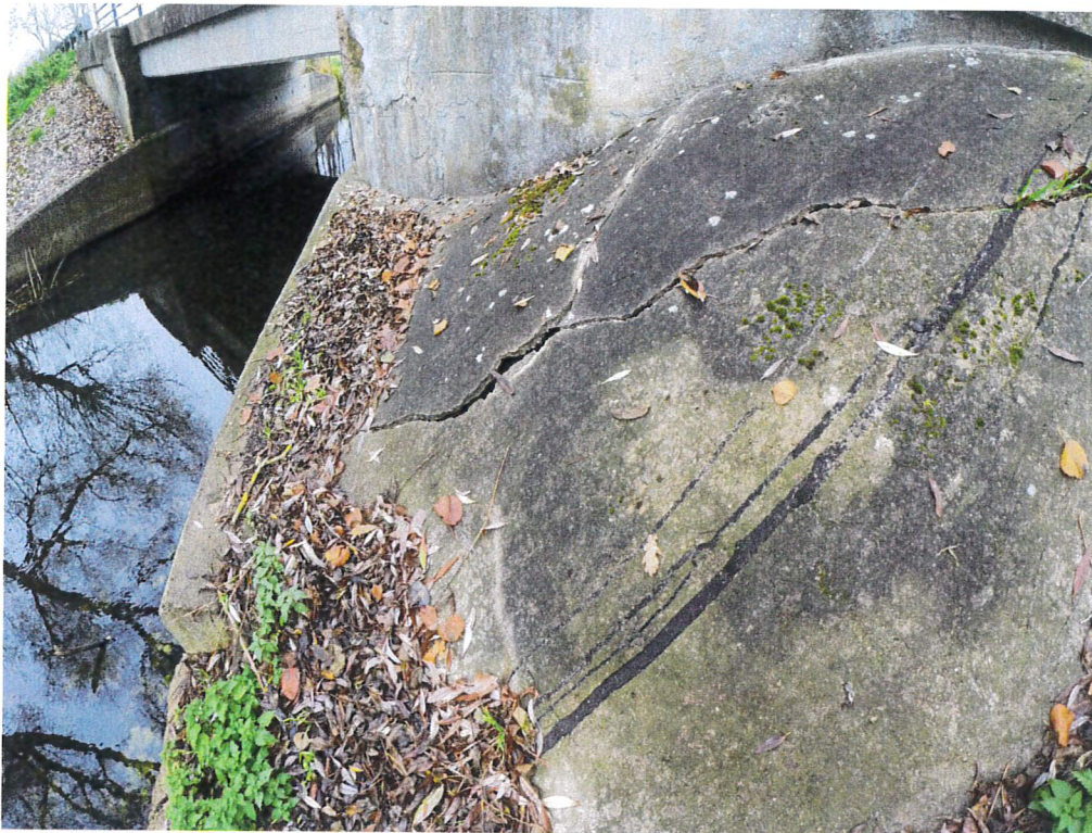
Fot. 2. Pęknięcia betonowego umocnienia nasypu
